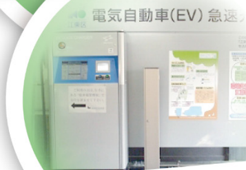
EV用急速充電器
