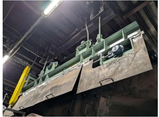
磁選機（復旧後）
