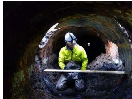
河川管路の破損
