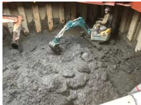
地下水による泥土状況
