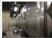
耐震性貯水槽
