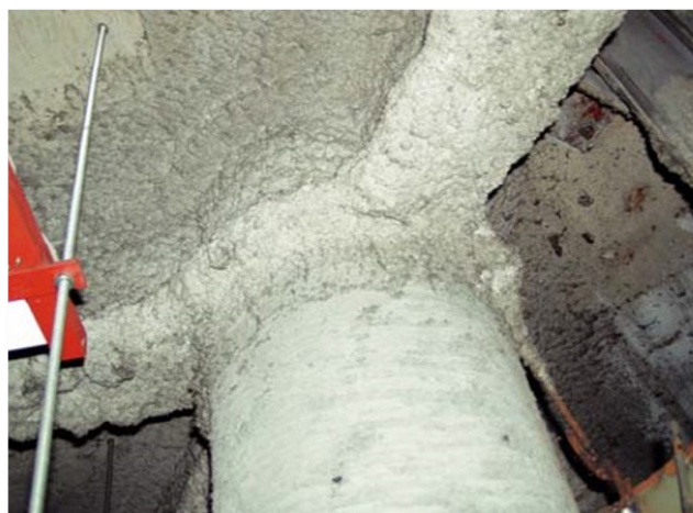
吹付け石綿（鉄骨耐火被覆材）
