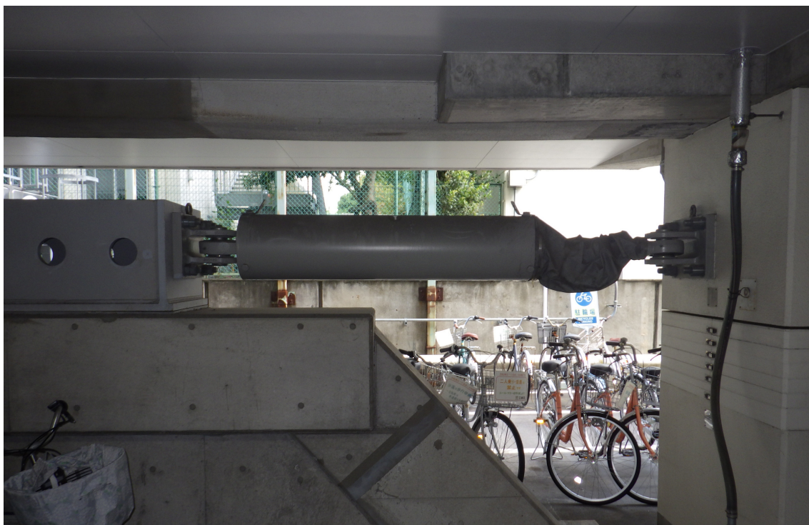
（写真） 免震用オイルダンパー全景
