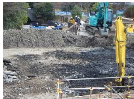
地中障害物（河床コンクリート）
