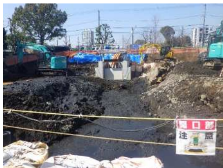
地下水の湧出状況
