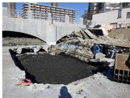
汚泥堆積状況
