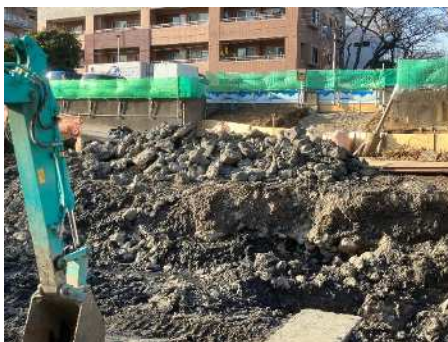
地中障害物（埋設コンクリートガラ）
