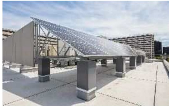
太陽光パネル
