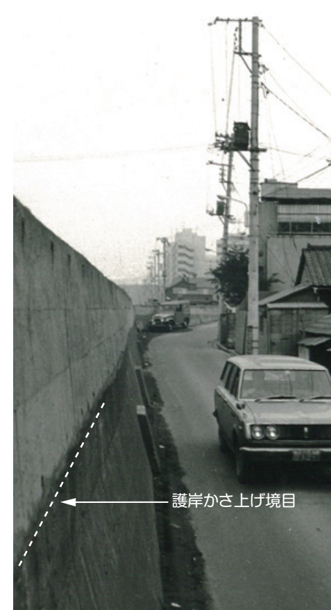
地盤沈下によりかさ上げた小名木川の護岸。昭和45(1970)年9月30日 北砂6丁目
