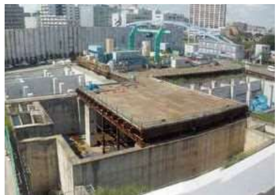
【都下水道局 小松川第二ポンプ所】 ・建設中の状況。 ・亀戸・大島地域に降った雨を荒川に直接排水する施設。より効果的な雨水排水が可能。
