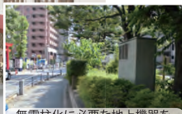
無電柱化に必要な地上機器を 公園に設置した事例(富岡地区)
