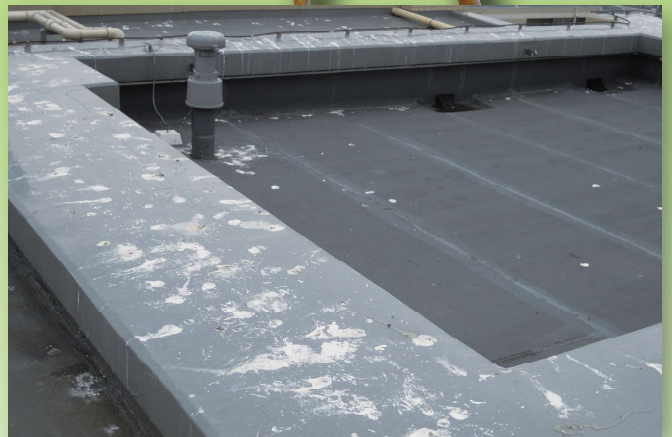
【フンによる屋上の汚れ】
