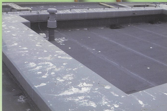
【フンによる屋上の汚れ】
