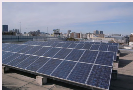
太陽光パネル
