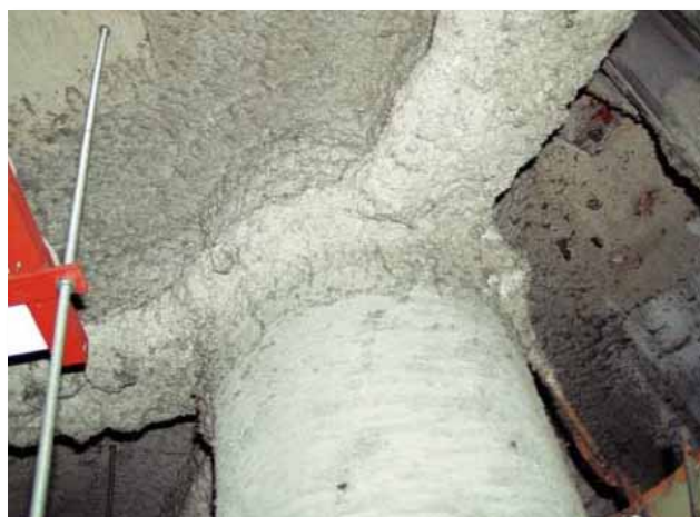
吹付け石綿（鉄骨耐火被覆材）
