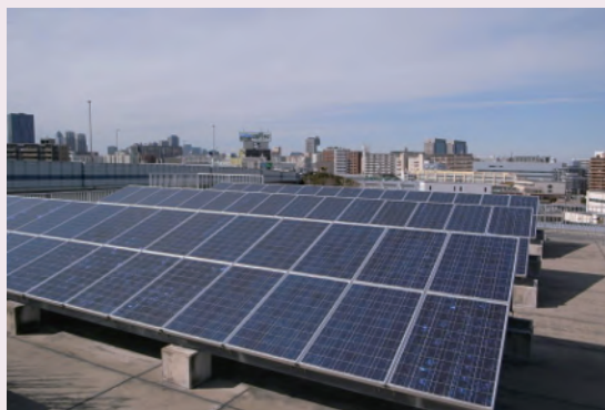
太陽光パネル
