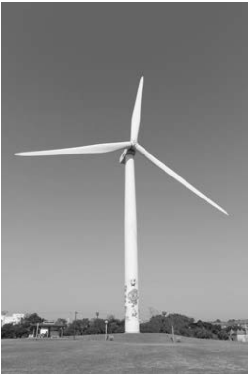
若洲風力発電施設
