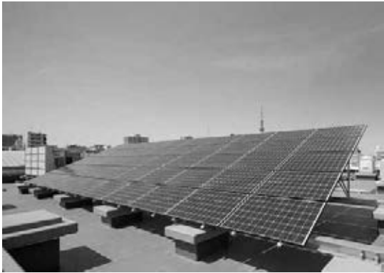
第二亀戸小学校設置 太陽光パネル
