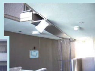
エキスパンションジョイントの落下被害
