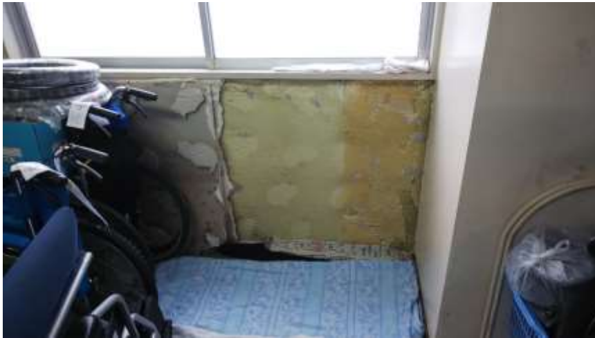
(降水時に雨漏りがあるため、内装部分を剥がしてある)
