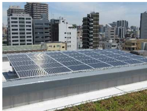
＜江東区こどもプラザ屋上の太陽光パネル＞
