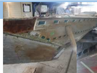
＜傷んだ船首や船底の様子＞
