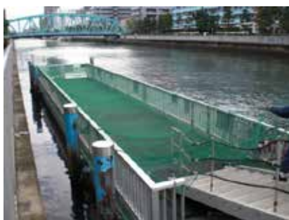
老朽化した高橋乗船場
