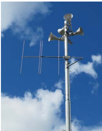
▲防災行政無線設備
