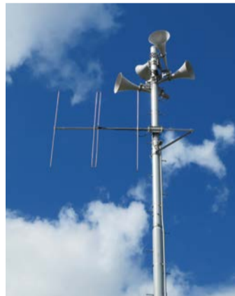
▲防災行政無線設備
