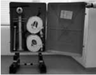
▲消火栓に直接ホースをつないで消火活動ができるスタンドパイプ
