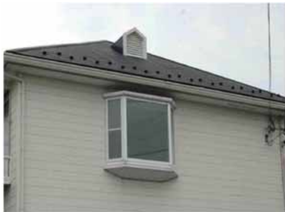
外壁に使われたアスベスト成形板
