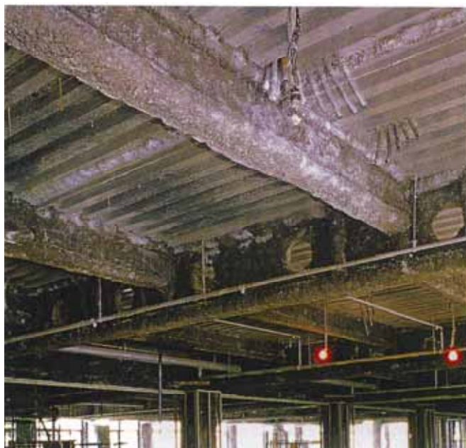
吹付けアスベスト 耐火被覆材（梁）
