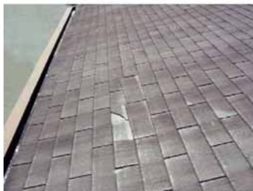
屋根に使われたアスベスト成形板
