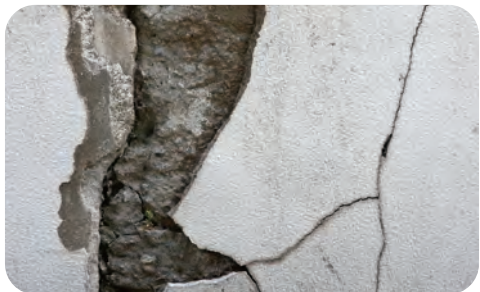
計画修繕等を支援して在宅避難の推進を 【劣化したマンションの外壁】
