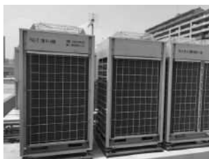
フロン類を使用した室外機
